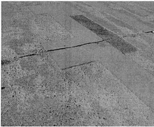
Рис 2. Рулѐжная дорожка а/п Пулково через 10 лет после ремонта.
