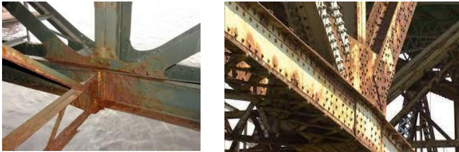
Рисунок. 1. Ураження елементів металевих конструкцій корозією
