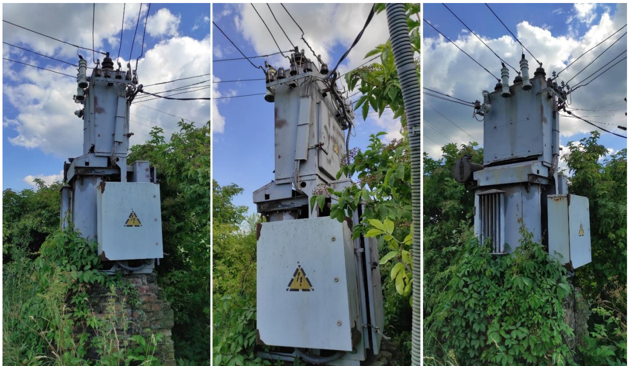
Рисунок 1. Трансформаторна підстанція в умовах навколишнього середовища
