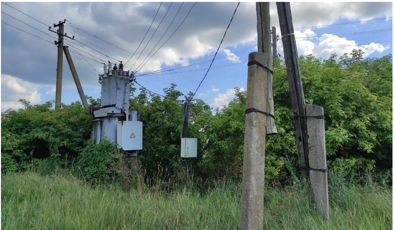
Рисунок 1. Трансформаторна підстанція та прилеглі до неї елементи
