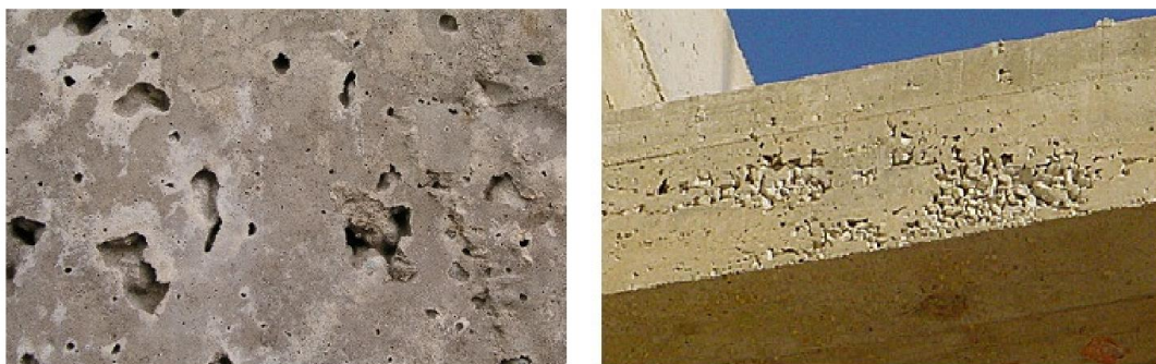
Рисунок 3 - Аномалії під час виконання: порожнечі та сегрегація бетон
