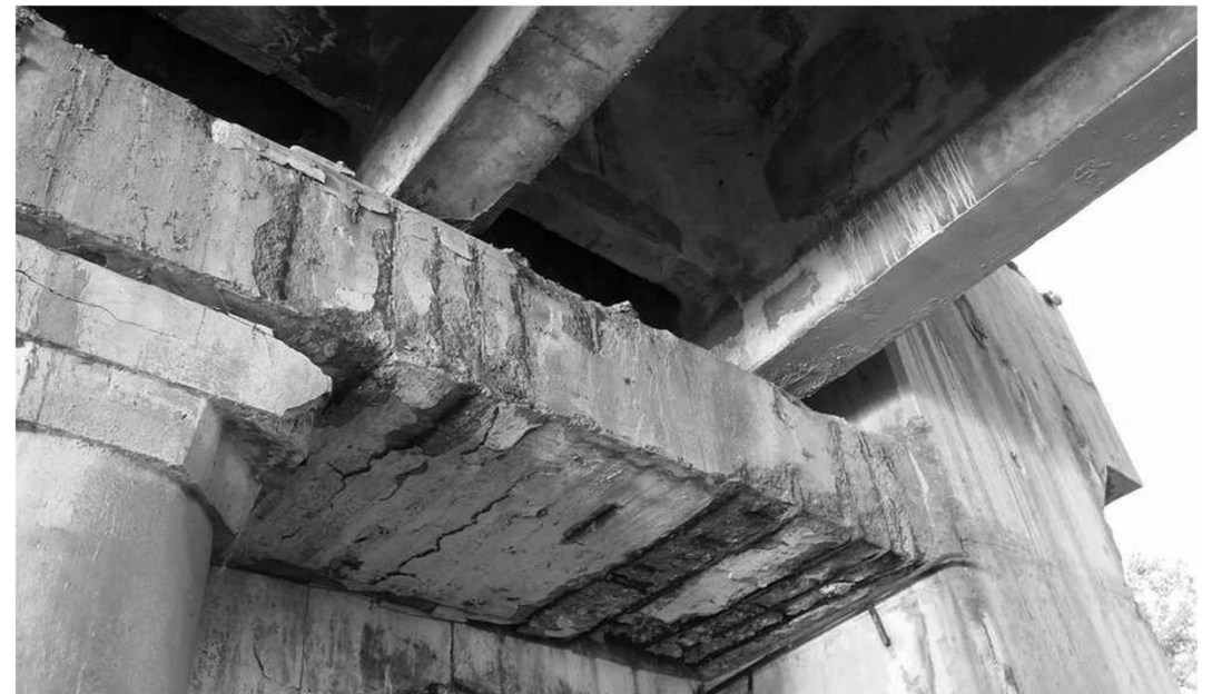
Приклади нормальних від вигину тріщин на мостових балочних конструкціях
