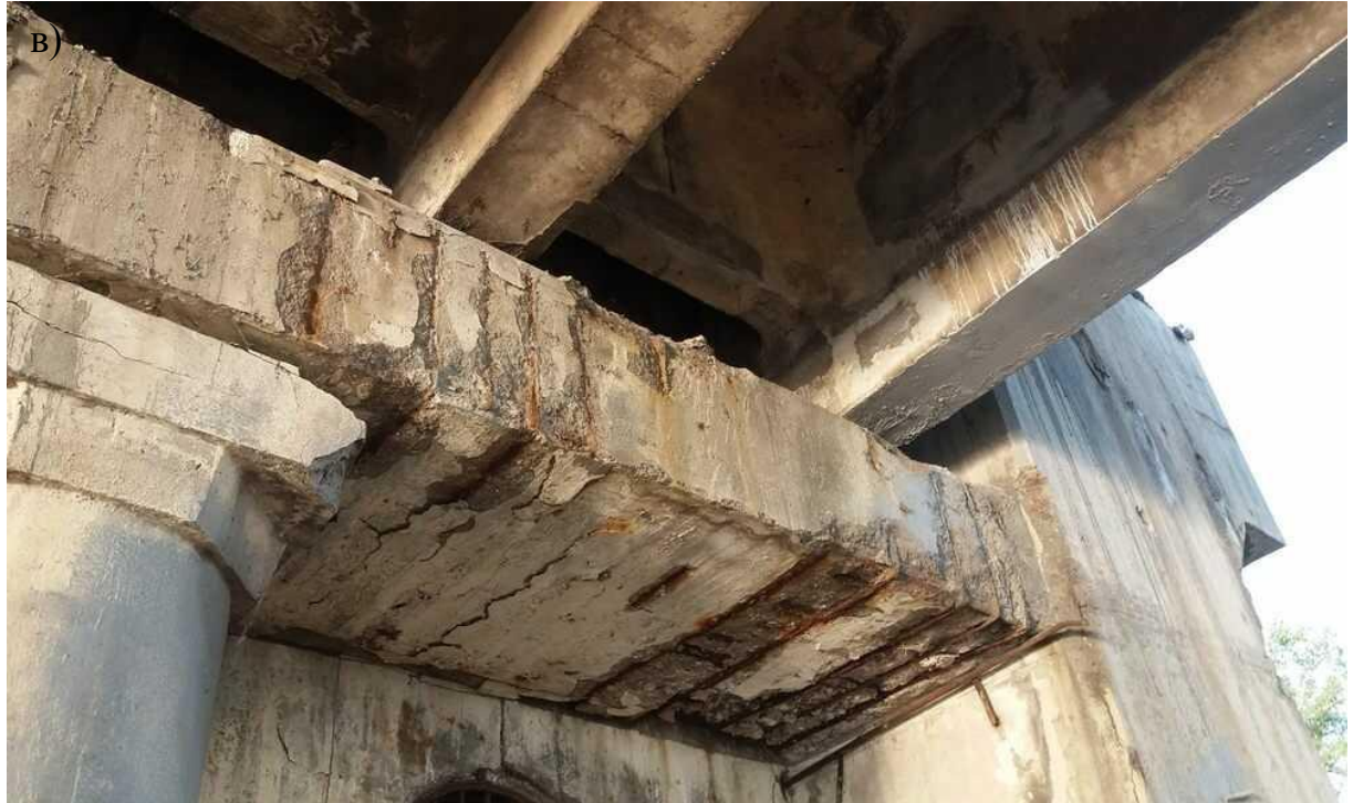
Рис. 2.1 Приклади нормальних від вигину тріщин на мостових балочних конструкціях
