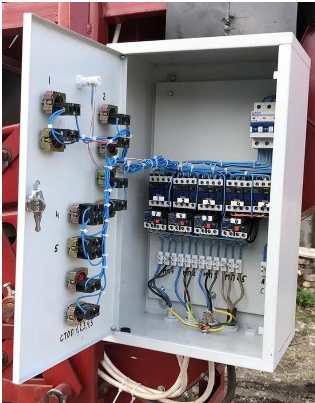
Рисунок 10. Щит електричний керування ОВС-25
