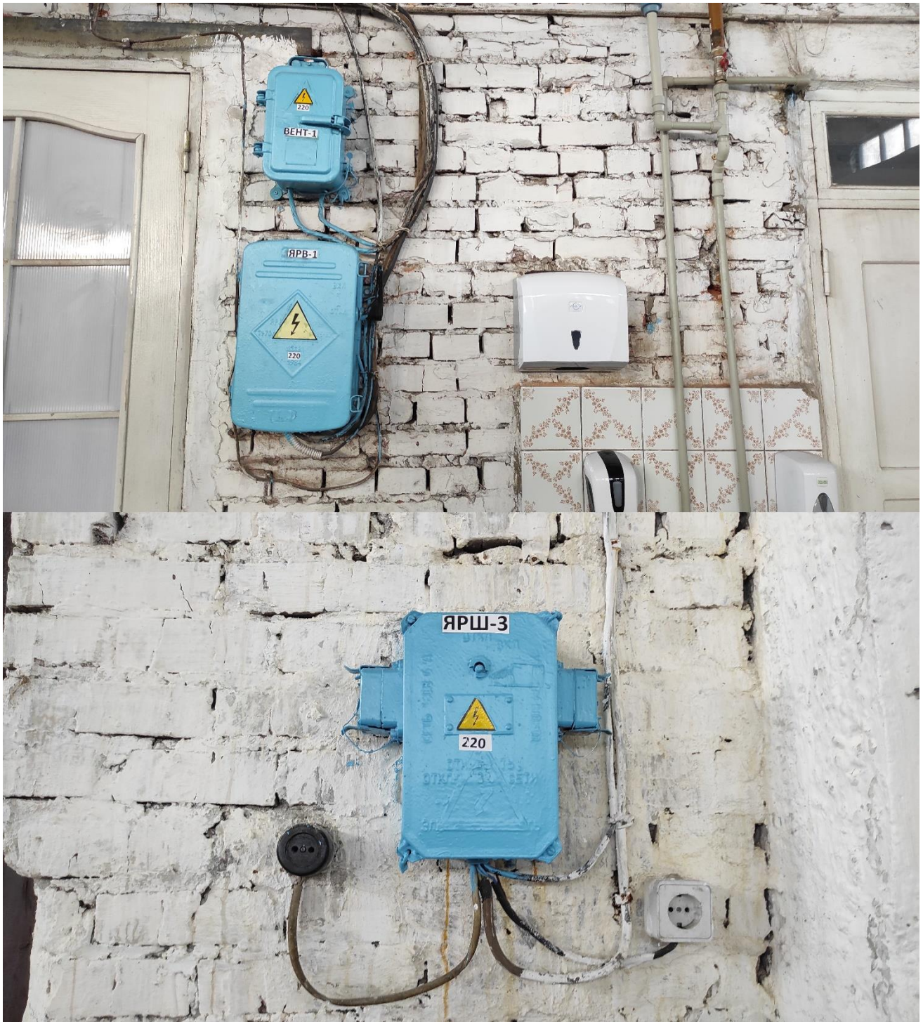
Рисунок 5. Додаткові щити електричні керування пристроями і обладнанням
