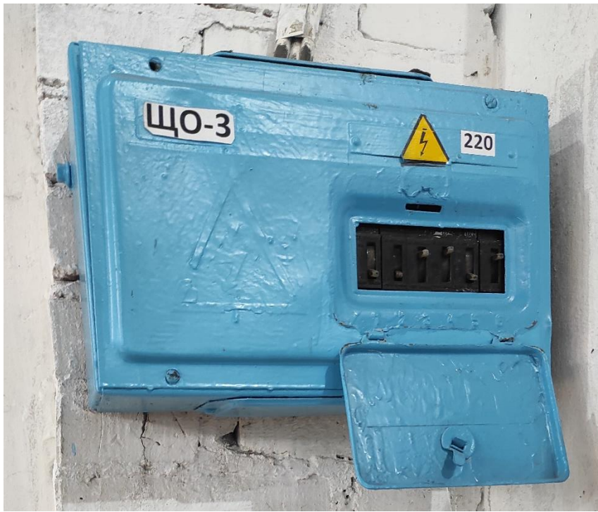
Рисунок 3. Щит електричний керування освітленням ремонтної майстерні
