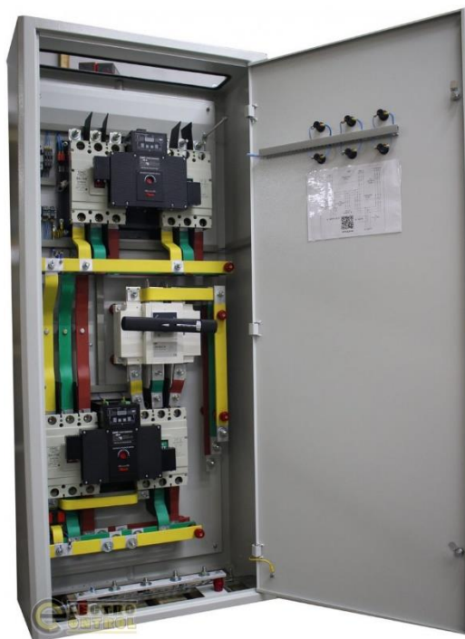
Рис. 5.1. ВРП із автоматичним вводом резерву типу АВР-400-3В-630А
