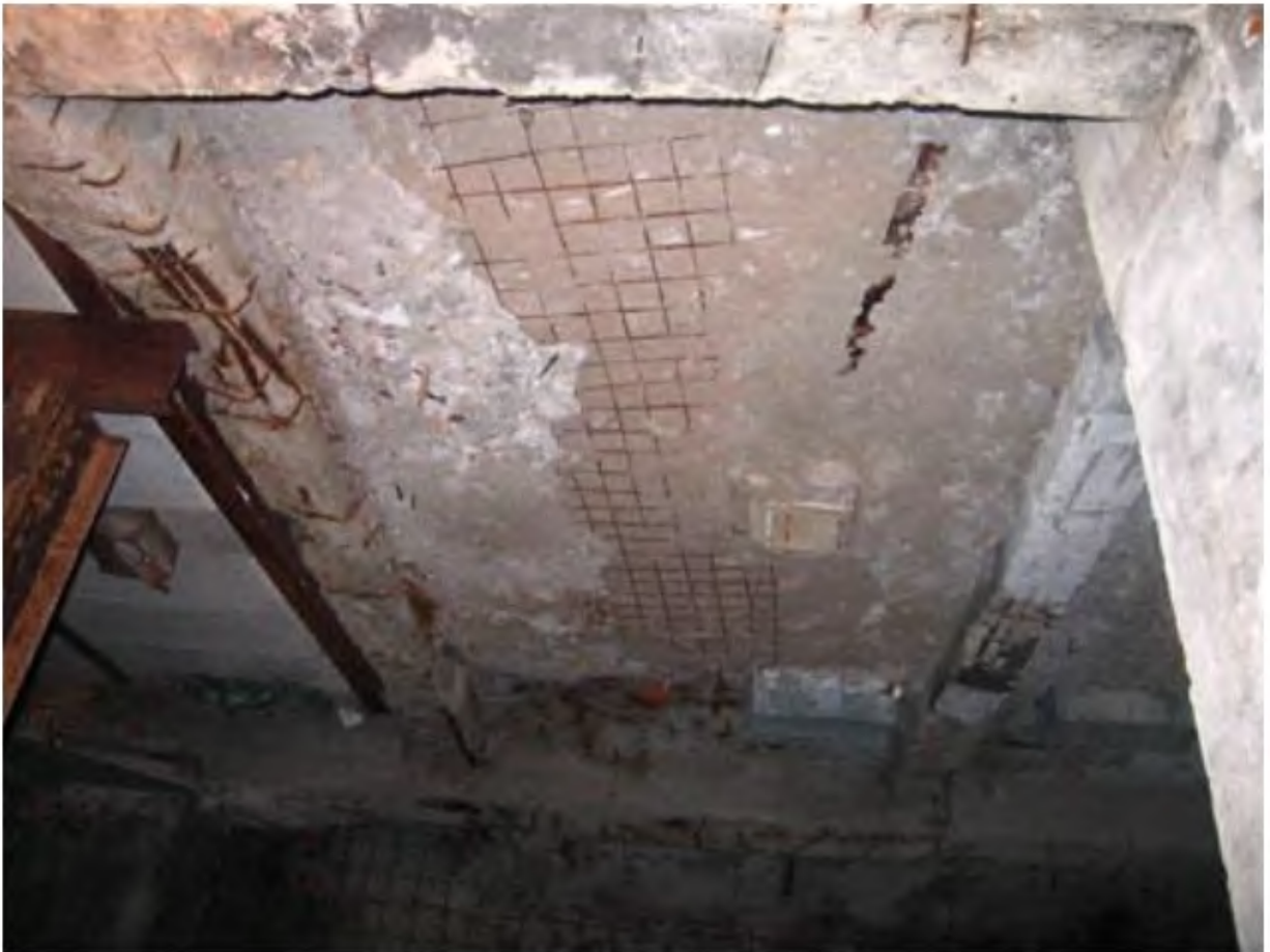
Рис. 1. Оголення арматури плити і балки
