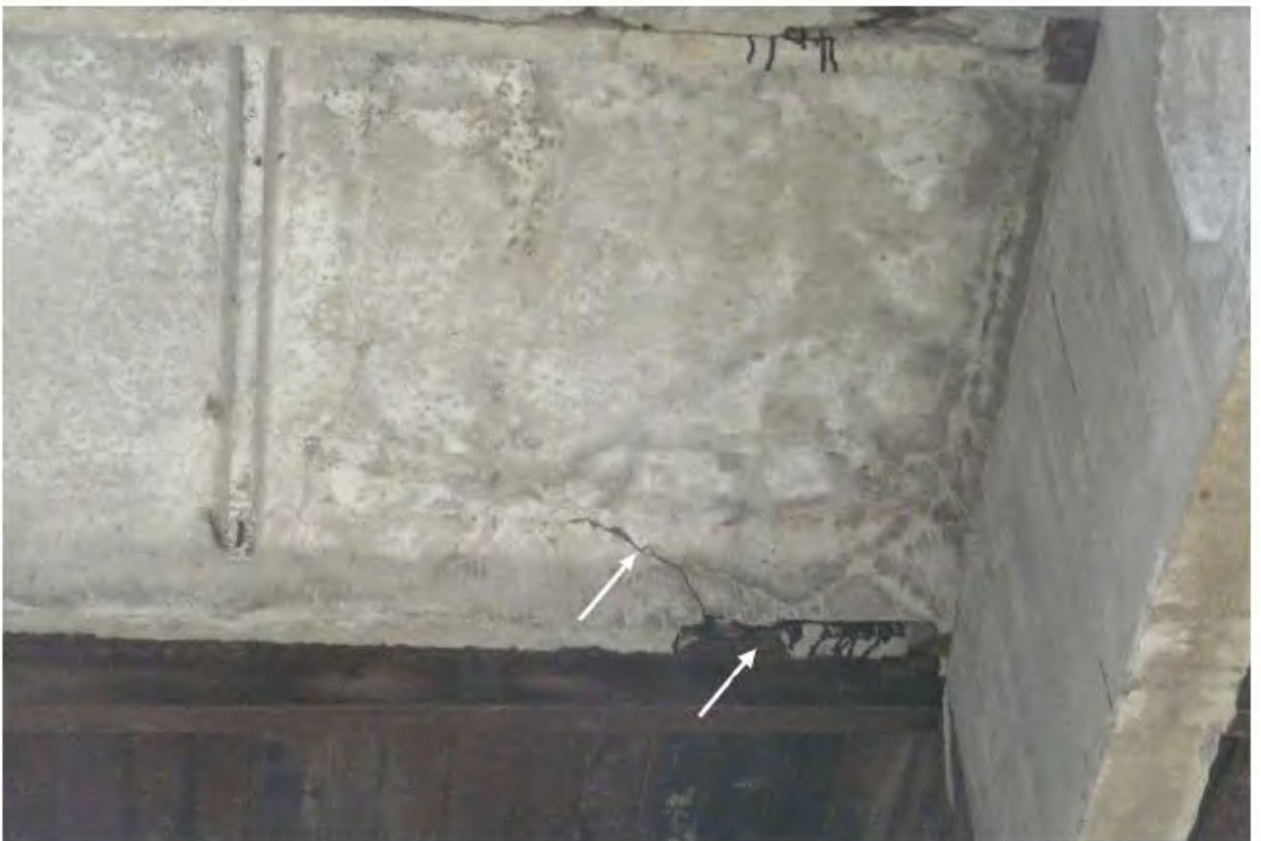
Рис. 2. Руйнування приопорної ділянки ребристої плити.
