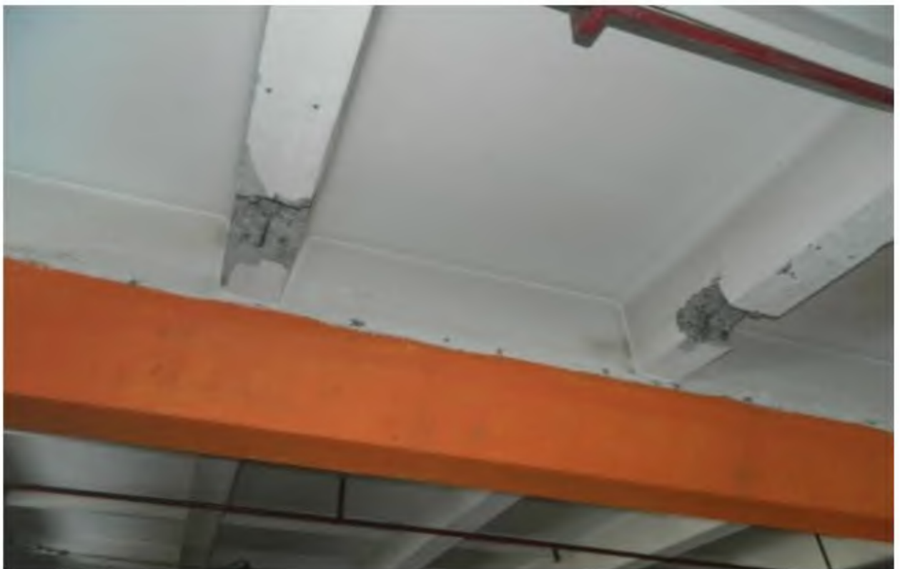
Рис. 4. Механічне руйнування поздовжніх ребер плит покриття. Вертикальні тріщини в поздовжніх ребрах перехідні на полицю плит шириною розкриття 1,0 ... 3,0 мм.
