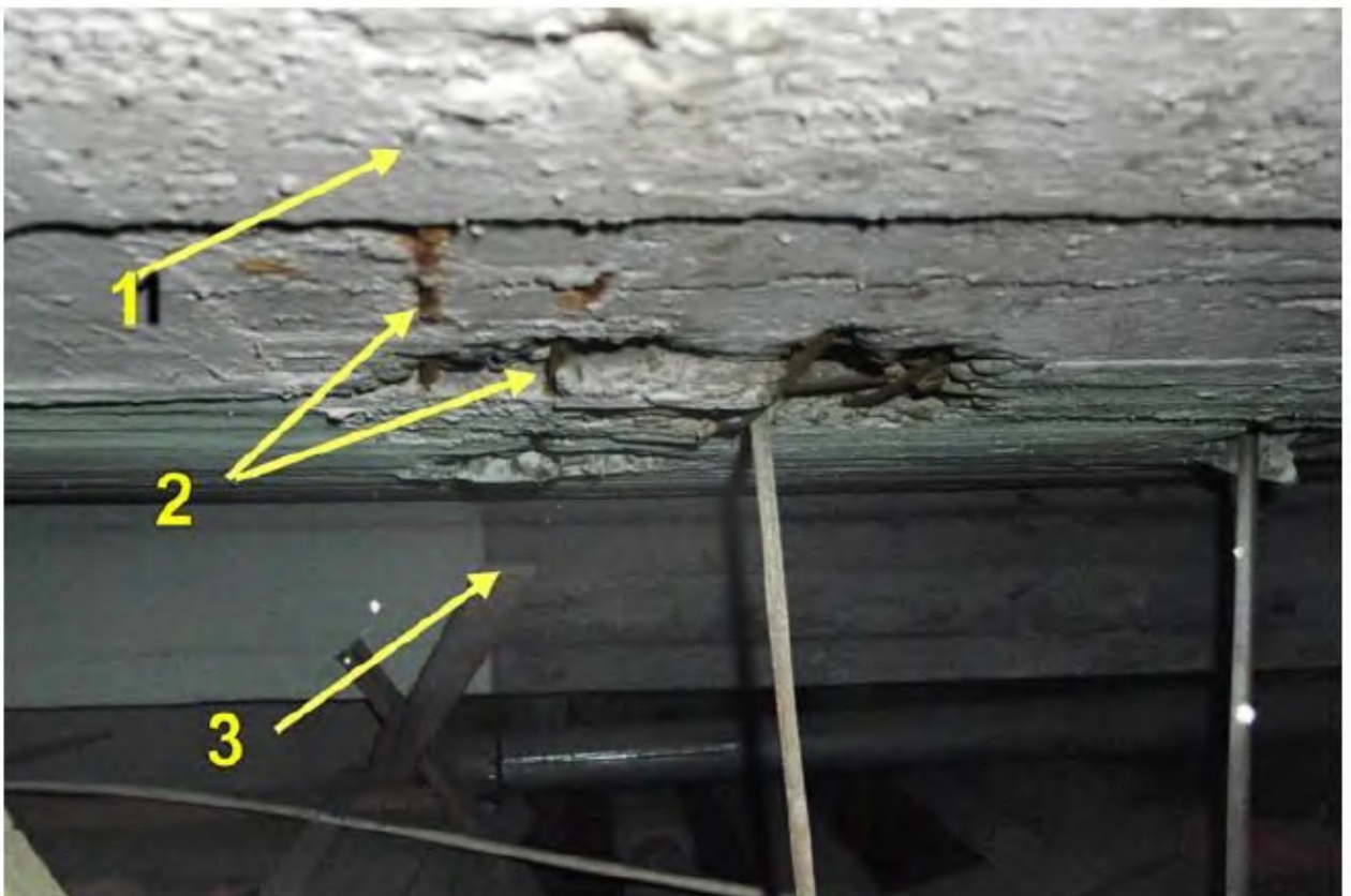
Рис. 2. Низ перекриття. (1 - характер поверхні; 2- дефекти і локальні сліди корозії; 3- підтримуюча балка перекриття в районі поперечної стіни)
