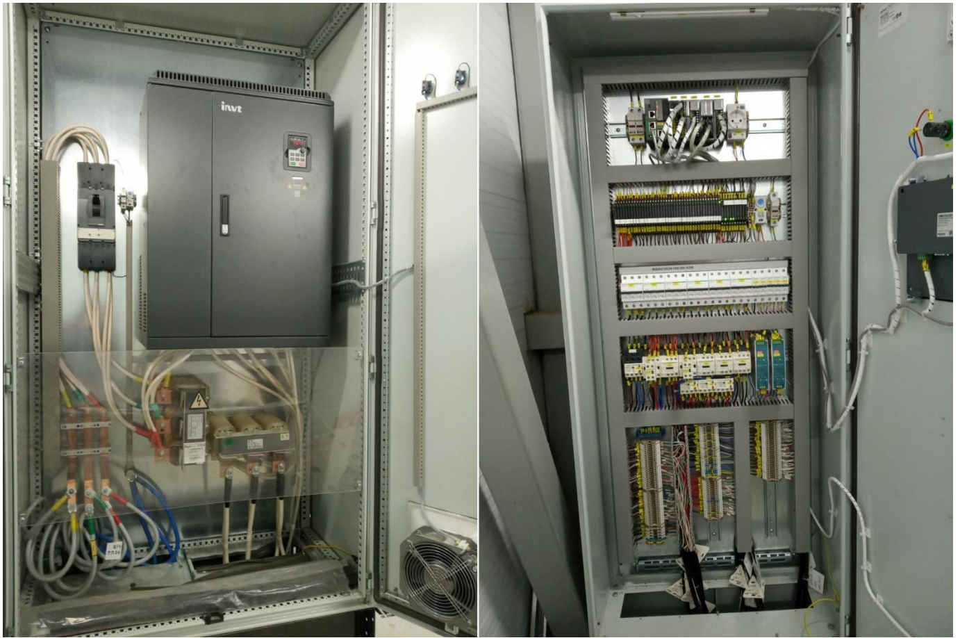
Рисунок 3.9. Щити електричні керування теплогенеруючим пунктом
