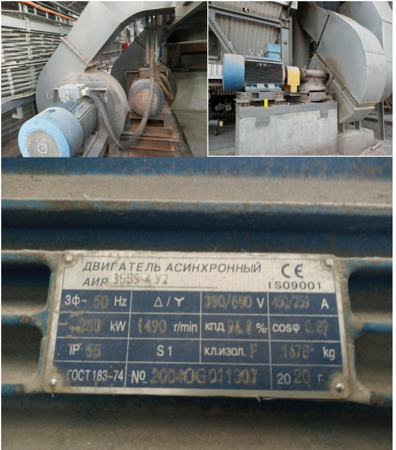
Рисунок 3.8. Приводні електричні двигуни теплогенеруючого пункту
