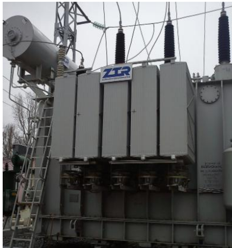
Рисунок 1.3 – Силовий трансформатор 110/35/10кВ потужністю 63МВА
