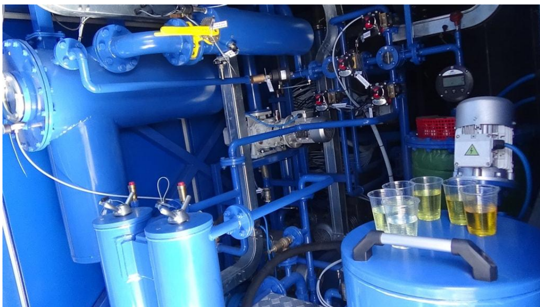
Рисунок 2.3 – Обробка трансформаторного масла
