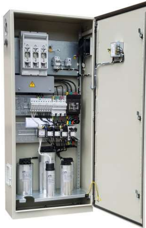
Рис. 3.2. Конденсаторна установка ККУ-04-180-10-21УЗ
