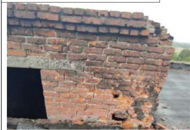
Ф.10 Руйнування кладки надбудови на даху
