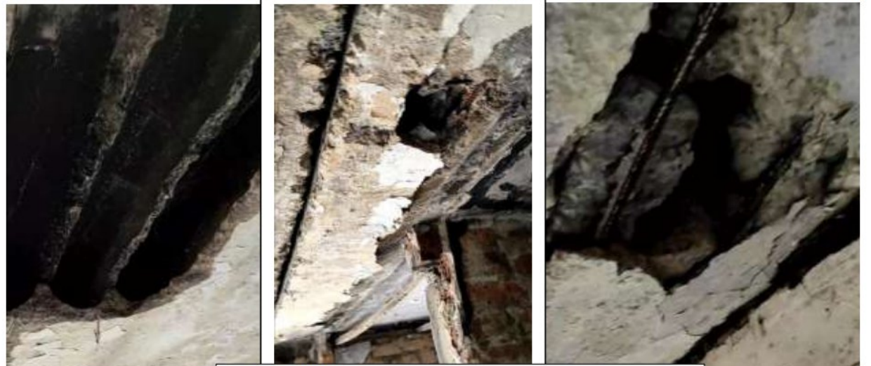
Ф.25,26,27 Руйнування плит перекриття на 5, 4, 3 поверхах
