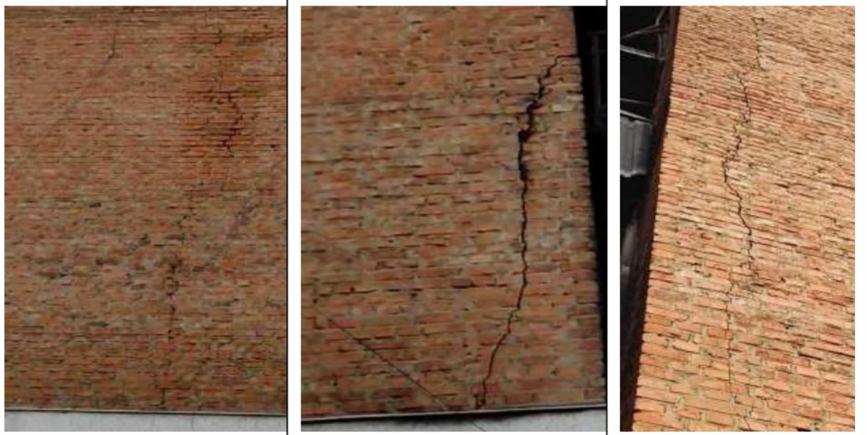
Ф.18,19 Тріщини цегляної кладки стіни на фасаді А-В
