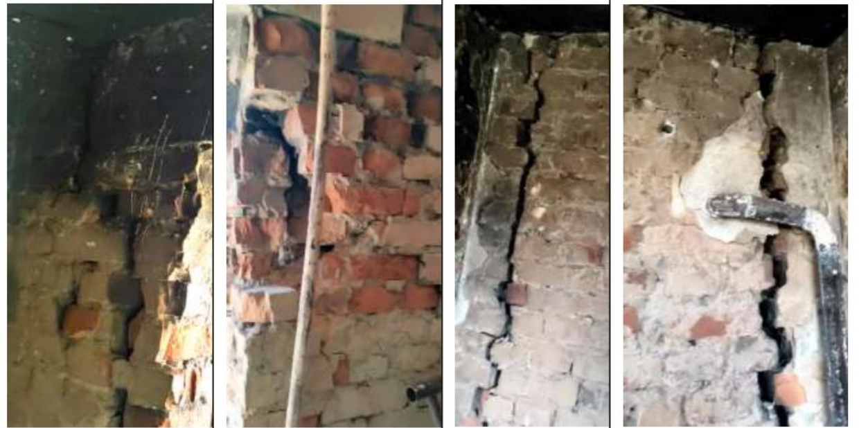
Ф.21,22 Тріщини стін на фасаді 1-7 і фасаді 7-1
