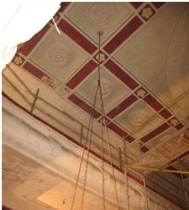
Фото 3.5. Сталеві тяжі для підвіски вантажів
