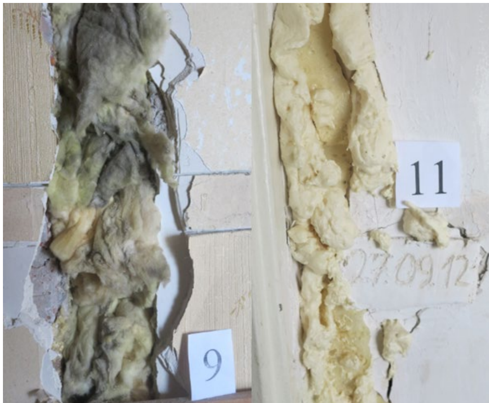
Рис. 2.19. Руйнування відкосів в дверних отворах 9-го поверху
