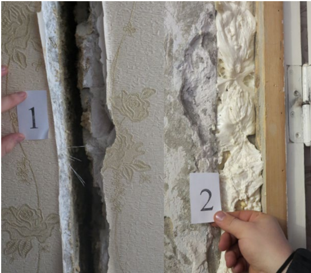
Рис. 2.18. Руйнування відкосів в дверних отворах 5-го поверху
