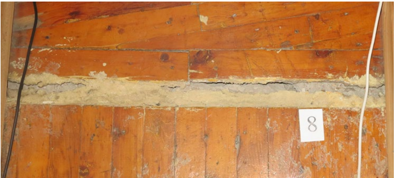
Рис. 2.20. Руйнування порогів в дверних отворах
