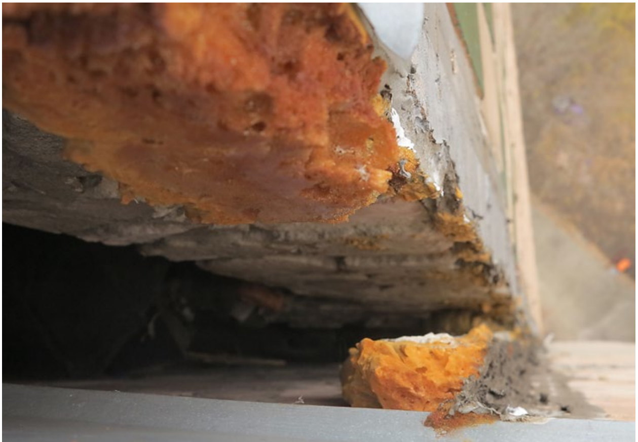
Рис. 2.17. Розкриття осадочного шва з боку заднього (вуличного) фасаду
