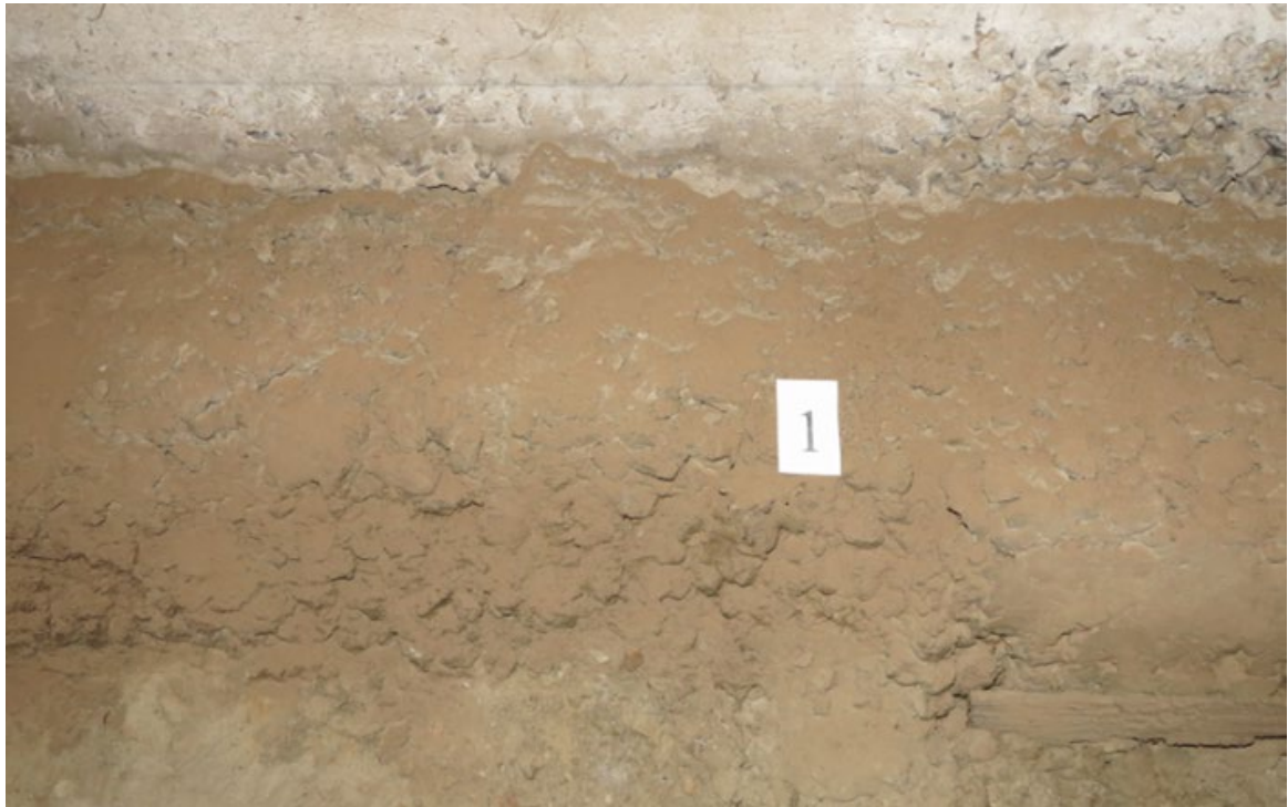
Рис. 2.15. Кам'янистий бетон цоколя між фундаментної плитою і фундаментними блоками (місцями з раковинами). Неякісне виконання опалубних робіт при будівництві.
