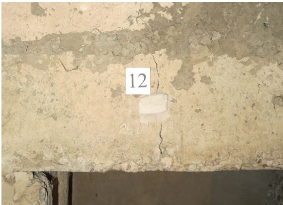
Рис. 2.16. Тріщини розкриттям від 0.5 до 3 мм в фундаментних блоках, розташованих над отворами цокольного поверху
