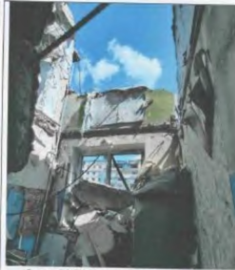
Фото №21 Руйнування панелей перекриття, покриття. Руйнування стінових панелей
