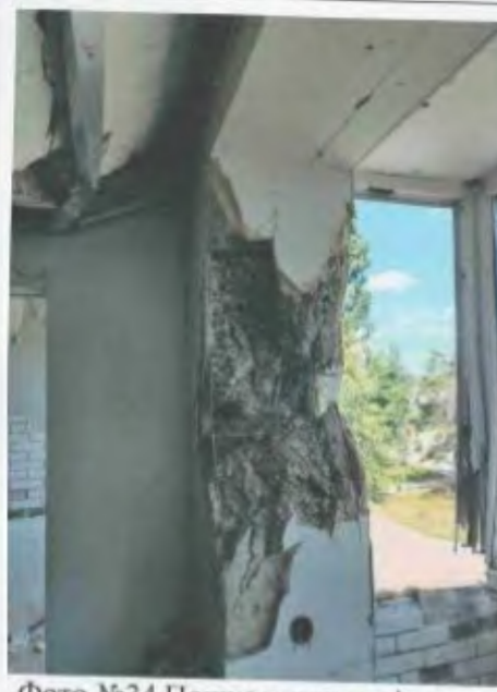
Фото №34 Пошкодження стінових панелей
