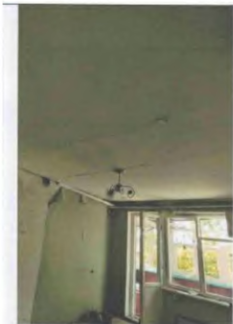
Фото №30 Руйнування панелей покриття
