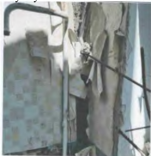
Фото №67 Руйнування системи газопостачання
