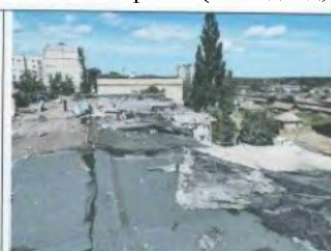
Фото №58 Руйнування покриття
