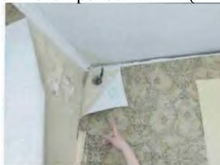
Фото №42 Замокання стін. Замокання системи електропостачання
