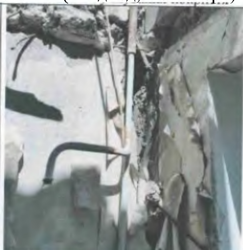
Фото №68 Руйнування системи газопостачання
