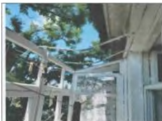
Фото №69 Руйнування покриття балкону
