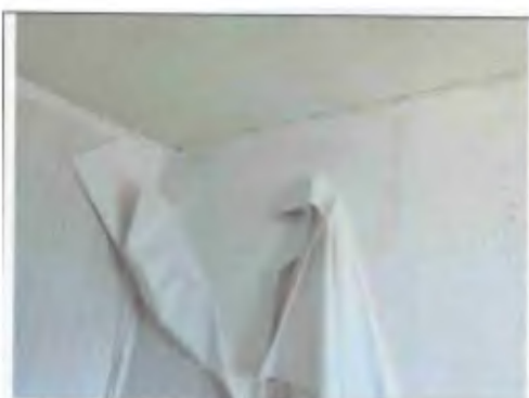
Фото №41 Замокання стін
