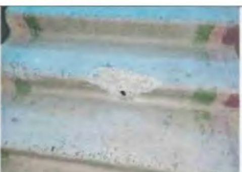
Фото №52 Пошкодження сходового маршу
