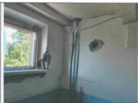
Фото №48 Пошкодження стінової панелю. Пошкодження вентиляційного каналу.
