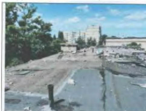
Фото №57 Руйнування покриття
