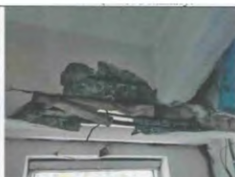
Фото №50 Пошкодження сходової площадки
