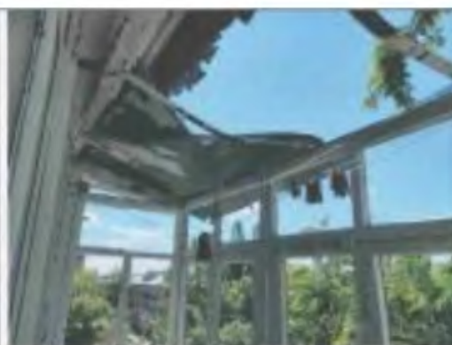
Фото №70 Руйнування покриття балкону
