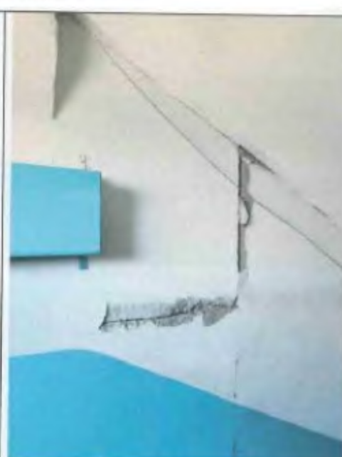
Фото №54 Висипання швів примикання стінових панелей.
