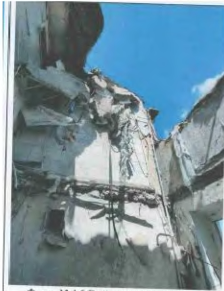
Фото №16 Руйнування панелей перекриття, покриття. Руйнування
