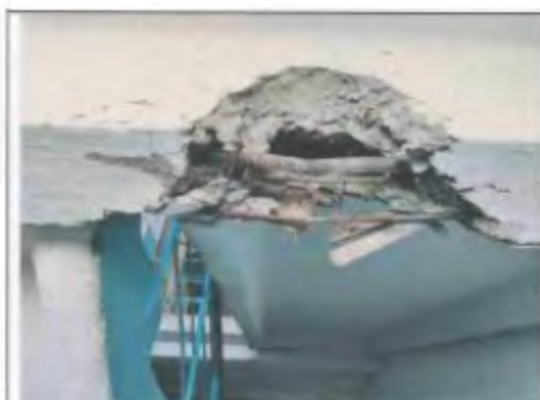
Фото №49 Пошкодження сходової площадки
