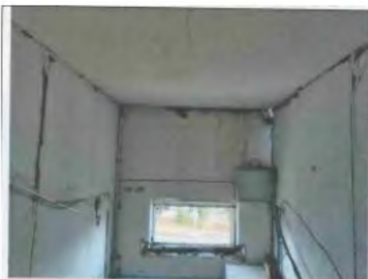
Фото №55 Замокання стін та стелі сходової клітини. Руїнування перекриття. Пошкодження стінових панелей
