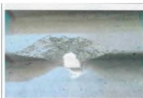
Фото №51 Пошкодження сходового маршу
