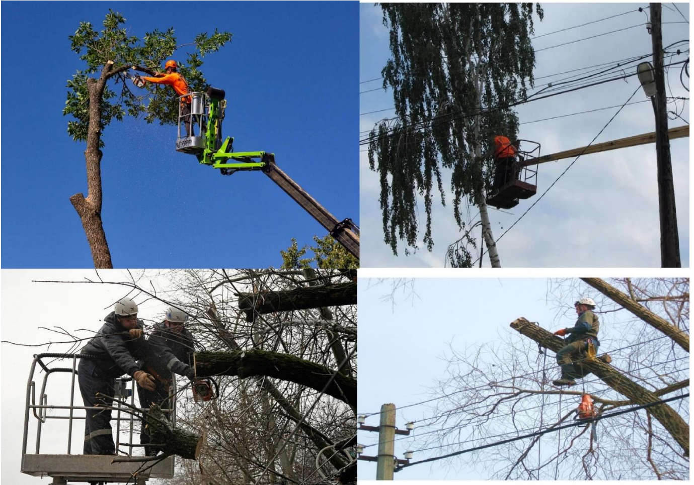
Рисунок 2.2. Знешкодження аварійних ситуацій при контактуванні зарослих масивів з лініями електропередачі
