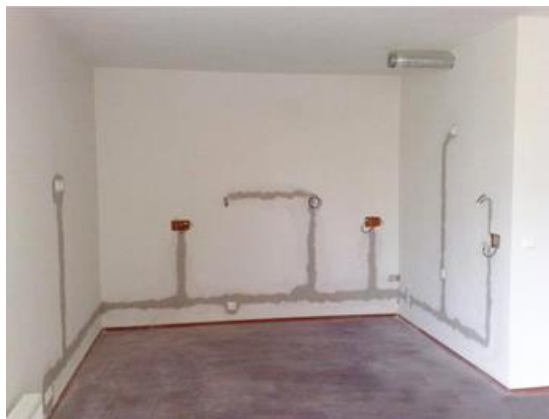
Рисунок 2.3 – Прихована проводка в штробах
