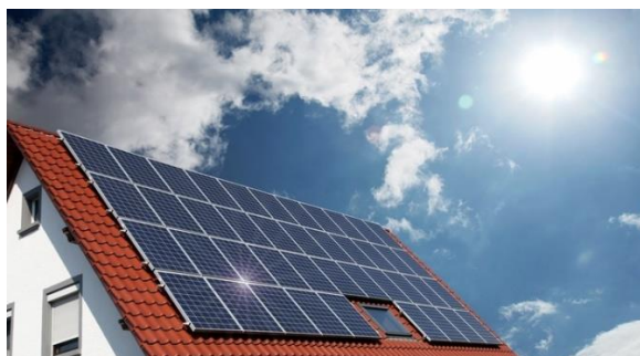
Рисунок 2.6 – Дахова сонячна електростанція
