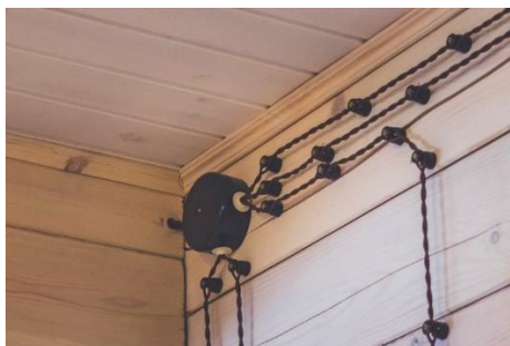
Рисунок 2.2 – Відкрита проводка на ізоляторах
