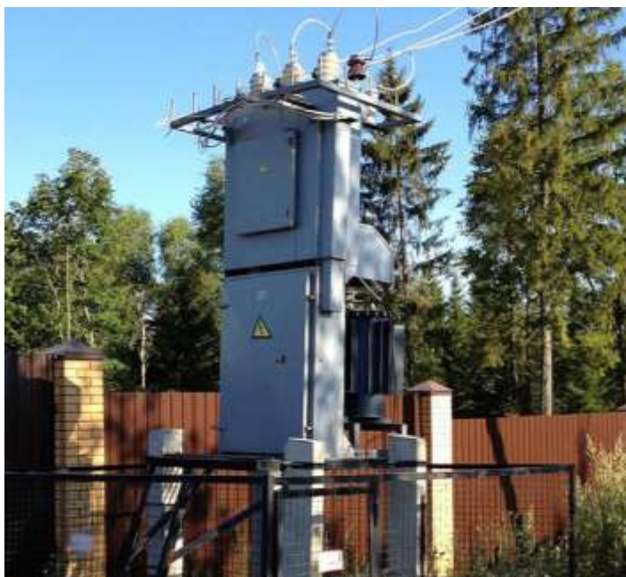
Рис. 1.2. Загальний вид існуючої КТП 10/0,4 кВ
