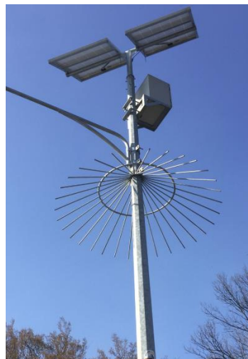
Рисунок 2.8 – Вулична освітлювальна LED установка з сонячною панеллю та акумулятором
