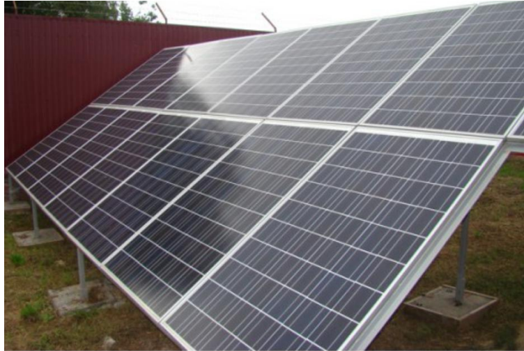
Рис. 2.1 – Фотоелектричний масив потужністю 6 кВт
