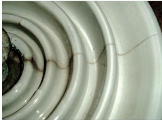
Рис. 1.2 – Дефекти полімерного ізолятора після тривалої експлуатації
