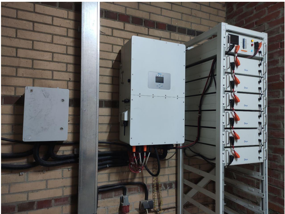
Рис. 2.9. Змонтована система обладнання сонячної електростанції перепелятника
