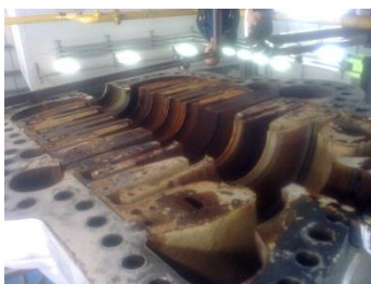
Рисунок 5 - Нижняя часть корпуса центробежного компрессора после долгих лет эксплуатации.
