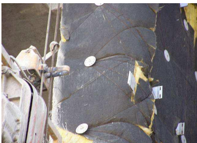
Рис.3.7- Характерні випадки недотримання технології монтажу утеплювача
